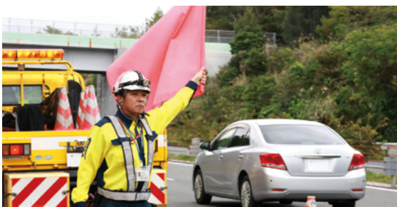
高速道路警備では、保安用資器材の設置・撤去、規制の監視・交通誘導まで、総合的に施工をサポート。
